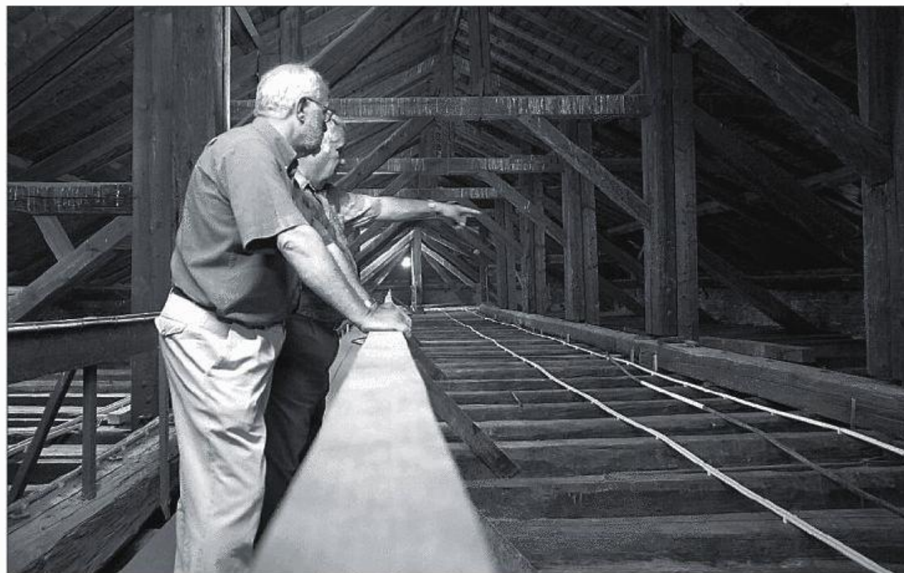
Pfarrer Stephan Augst und „Baubetreuer“ Werner Merkler (im Hintergrund) werfen einen Blick in den Dachstuhl der Irlicher Pfarrkirche St. Peter und Paul. Im Holz hatten es sich – über viele Jahre unbemerkt – zahlreiche Schädlinge gemütlich gemacht. Sie werden nun entfernt und die Balken auf Vordermann gebracht. ■ Foto: Jörg Niebergall
